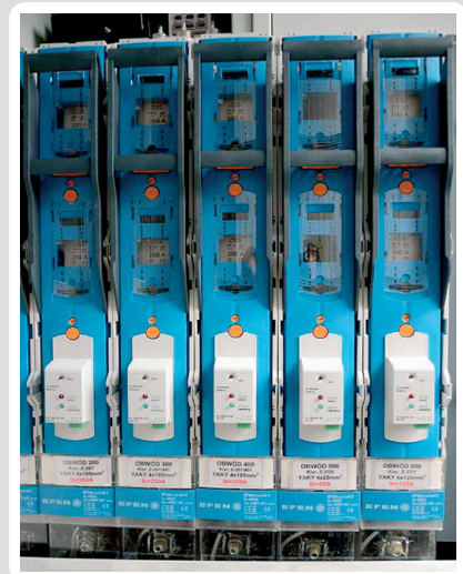
Fot. 3. Przykład rozdzielni nn z zastosowanymi sygnalizatorami przepalenia się wkładki bezpiecznikowej – sygnał o uszkodzonej wkładce bezpiecznikowej przekazywany bezpośrednio przez system SCADA do prowadzących ruch sieci
