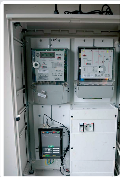
Fot. 1. Szafka z układem bilansującym zamontowana w budynku stacji transformatorowej SWN/nn
